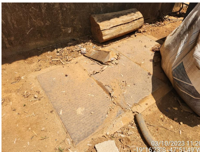
Figura 32 Caixa separadora de água e óleo do posto de abastecimento
