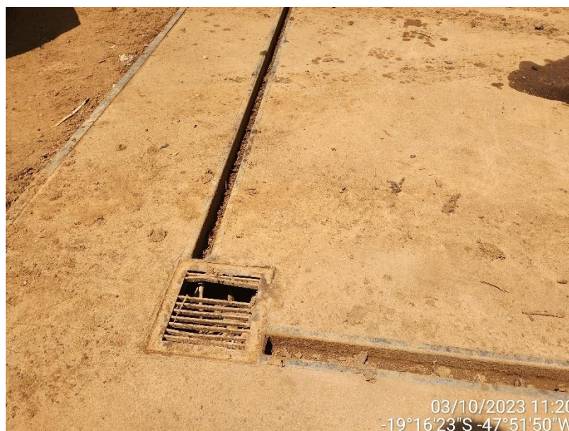
Figura 13 Canaletas de direcionamento
