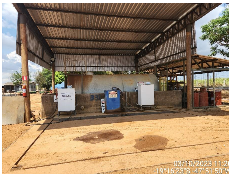
Figura 11 Vista frontal do posto de abastecimento
