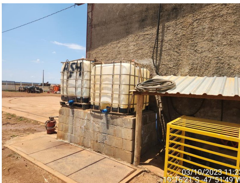
Figura 34 Caixa separadora de água e óleo do lavador
