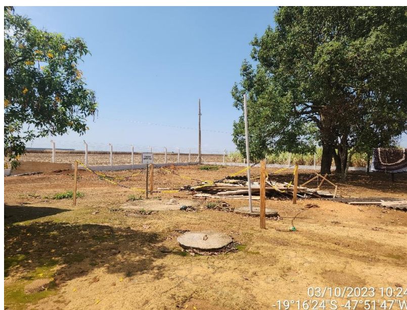
Figura 28 Fossa séptica casa 3
