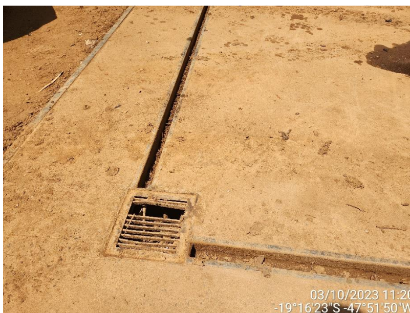
Figura 31 Canaletas do posto de abastecimento
