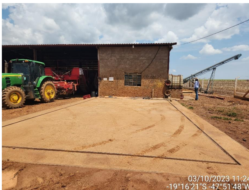
Figura 33 Canaletas do lavador de veículos
