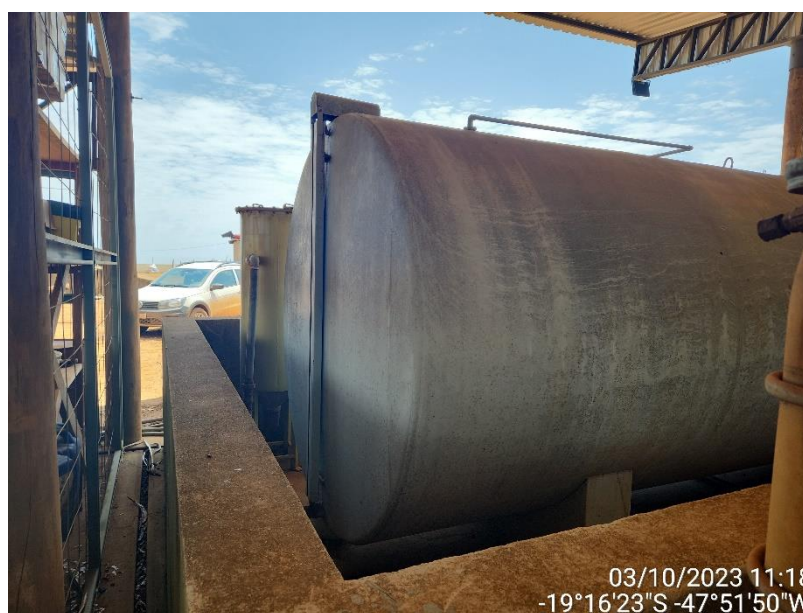
Figura 12 Tanque com capacidade de 15m 3
