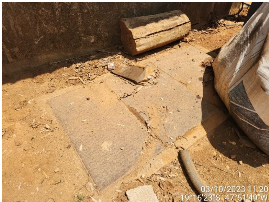
Figura 4.7 – Caixa separadora de água e óleo
