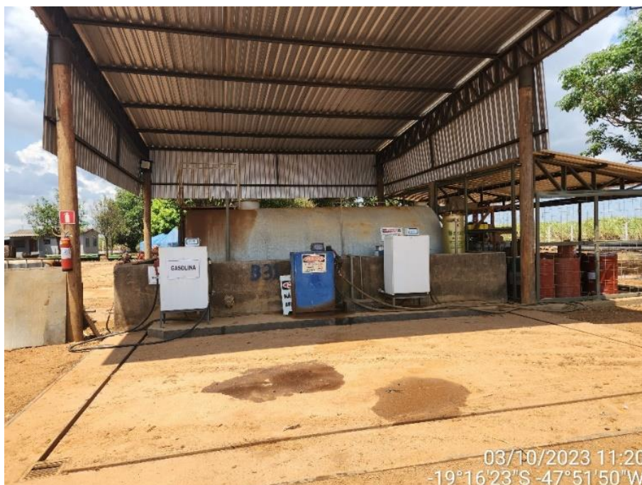
Figura 4.5 – Tanque de combustível
