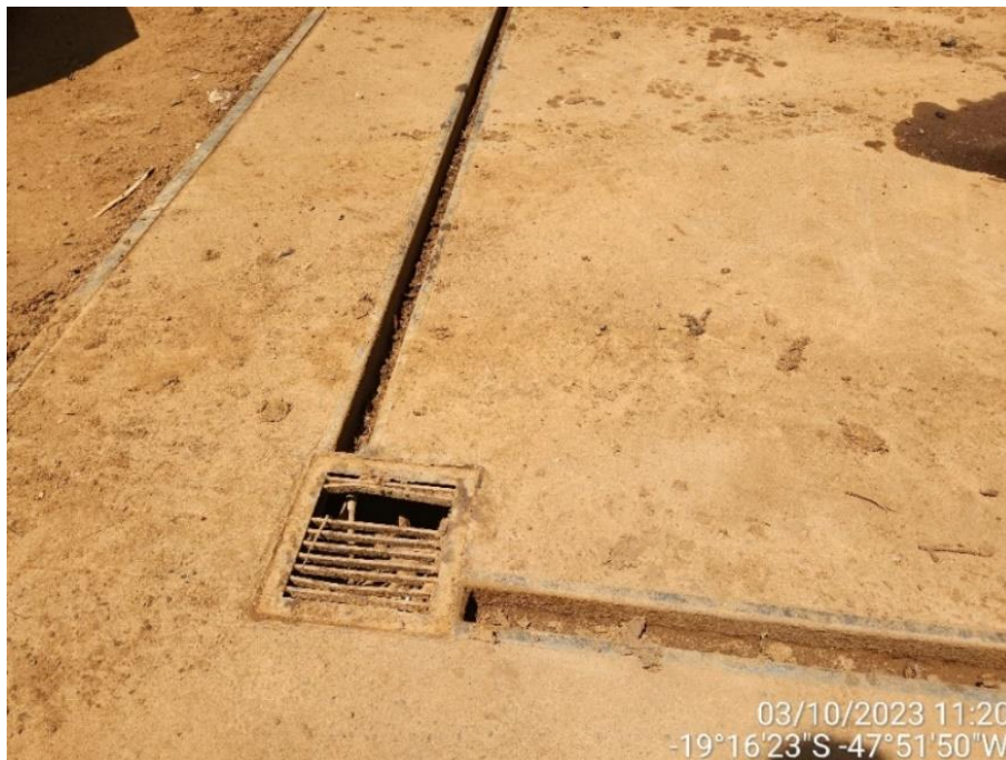
Figura 4.4 – Canaleta de contenção / Lavador de maquinários
