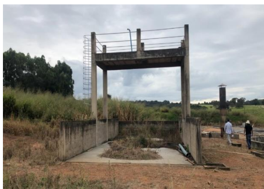
Figura 6.7 Separador de sólidos
