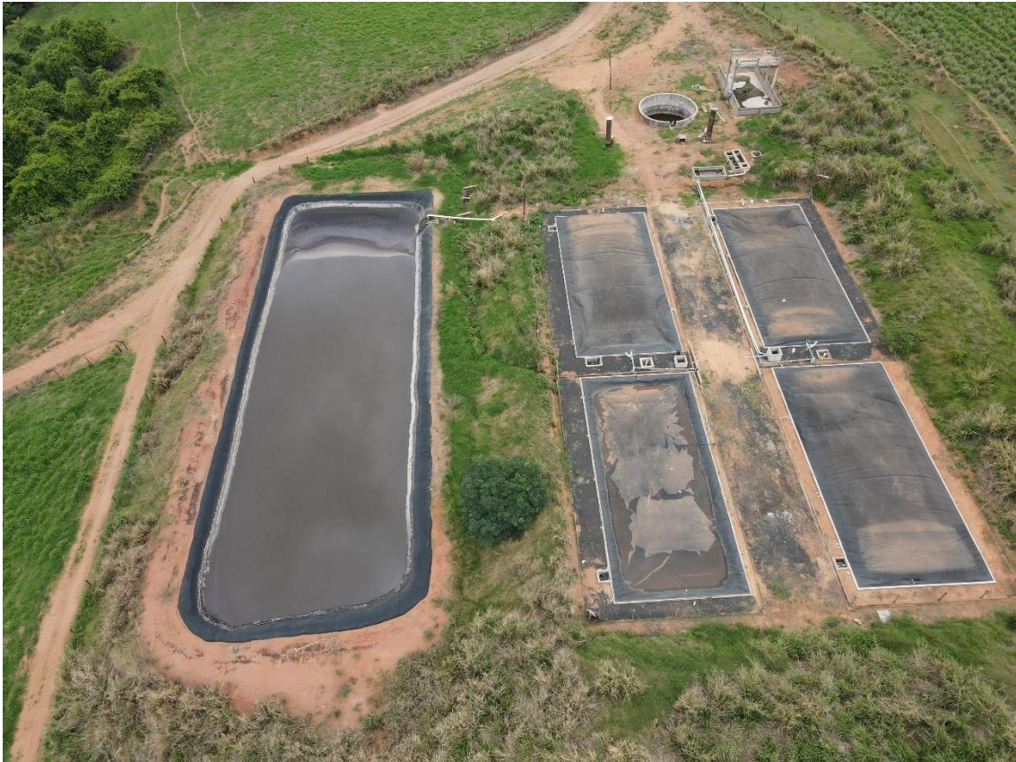
Figura 6.6 Estruturas do biodigestor
