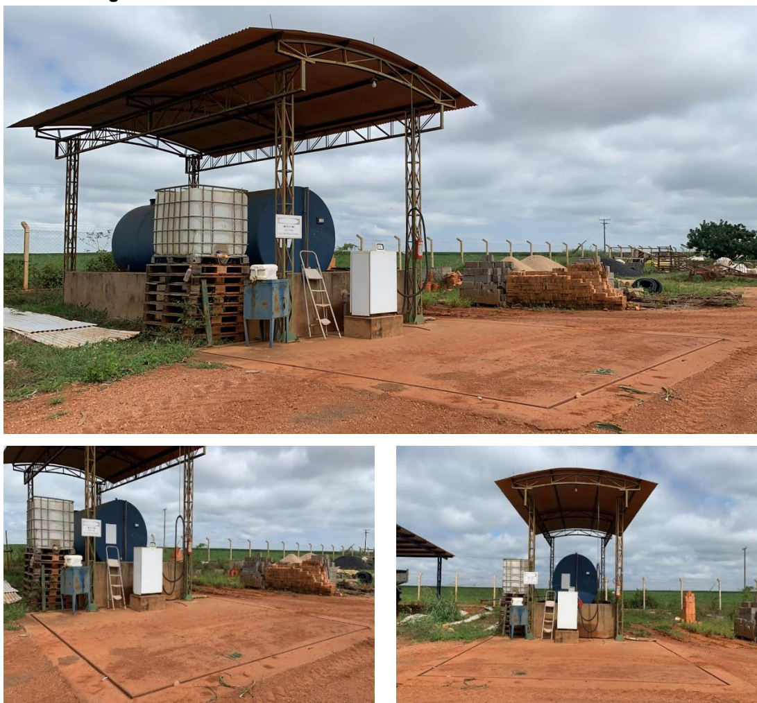
Figura 6.17 Posto de abastecimento de combustíveis com canaletas
