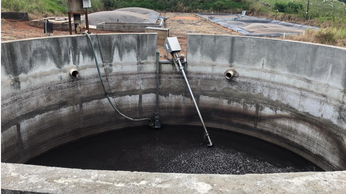
Figura 15.31 Separador de sólidos
