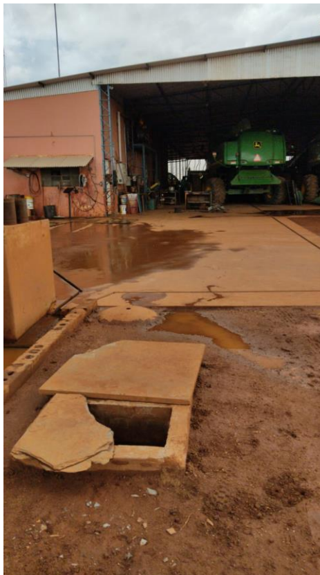
Figura 15.12 Caixa separadora de água e óleo / Lavador de máquinas
