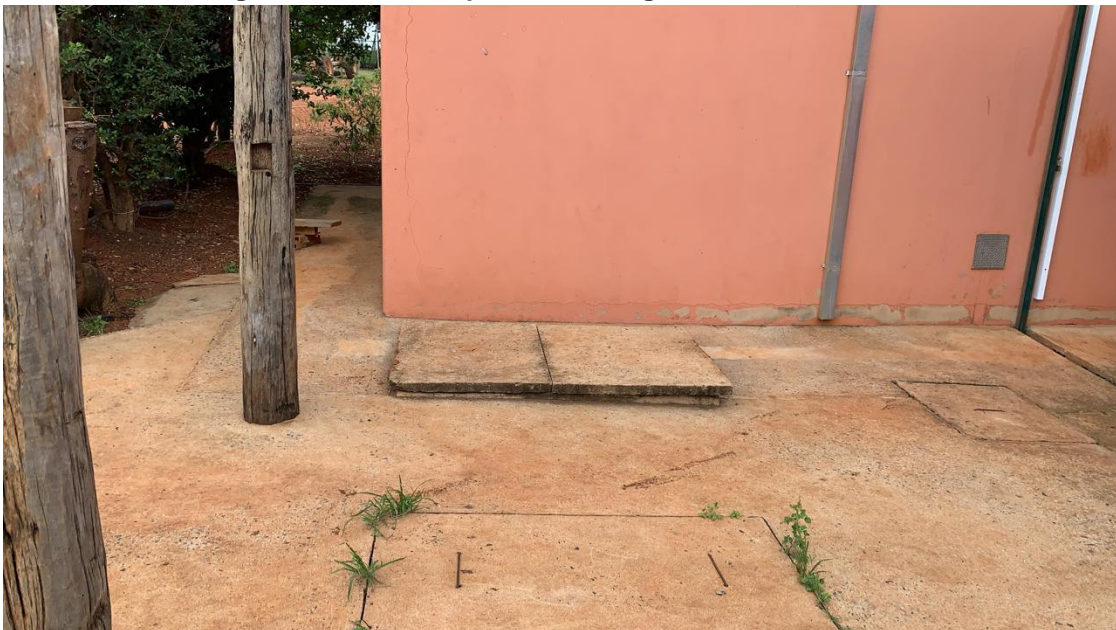
Figura 19.5 Caixa separadora de água e óleo: Refeitório
