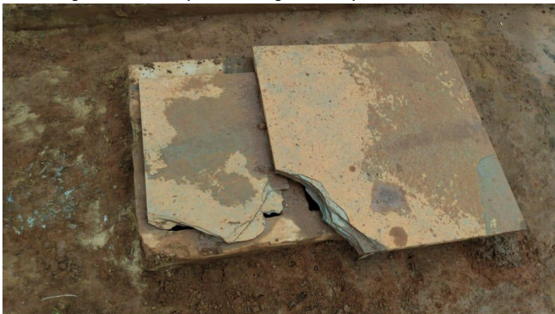
Figura 15.8 Caixa separadora de água e óleo - pista de abastecimento.
