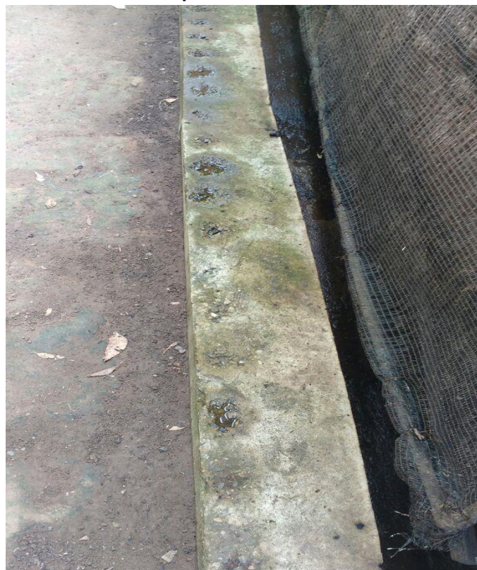
Figura 15.38 Canaleta da Composteira: canaliza o chorume ao biodigestor
