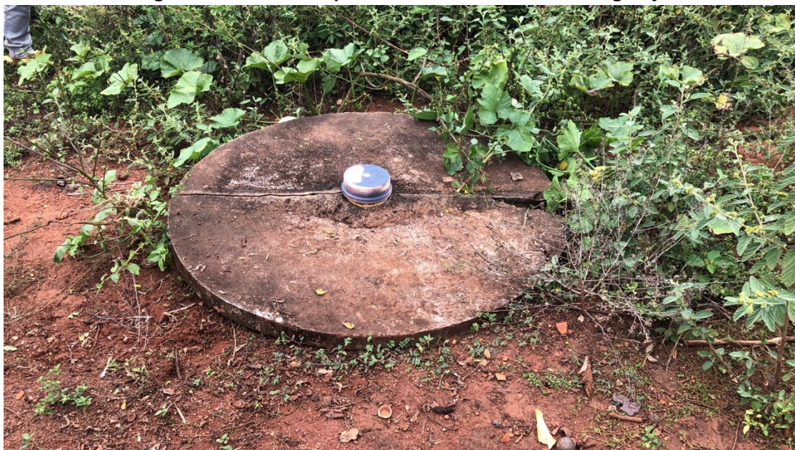
Figura 15.19 Fossa séptica - Casa do funcionário da granja
