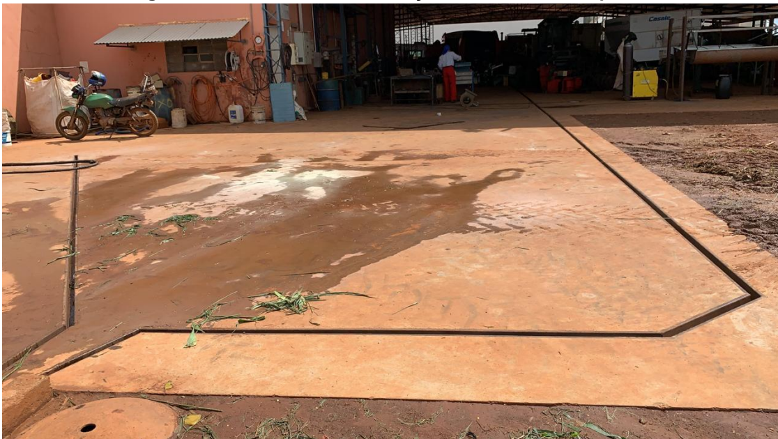
Figura 15.11 Canaleta de contenção / Lavador de máquinas
