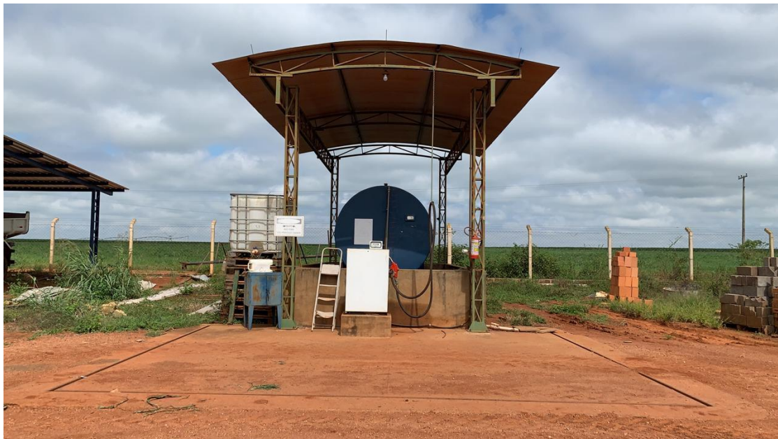
Figura 19.8 Equipamento extintor de incêndio: Posto de abastecimento de combustível
