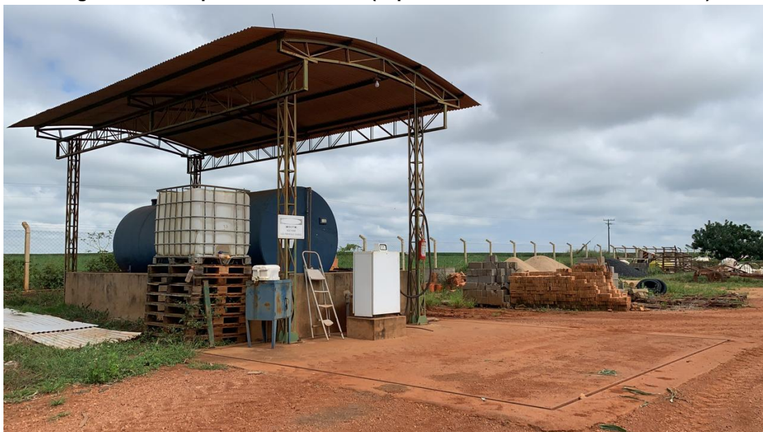
Figura 19.7 Tanque de combustível (capacidade de armazenamento: 16 m 3 )
