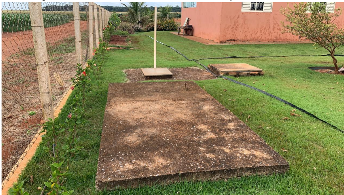
Figura 15.17 Fossa séptica - Casa do funcionário, próximo ao escritório
