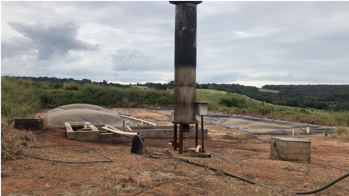
Figura 15.32 Biodigestor / Queimador de Gás
