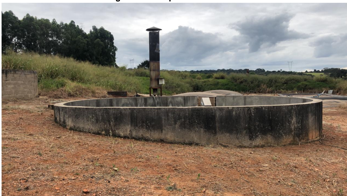
Figura 15.30 Separador de sólidos
