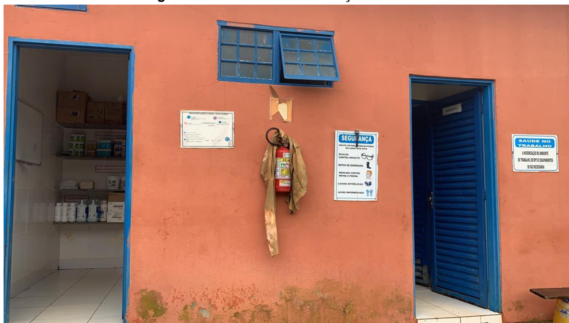
Figura 16.16 Placas de sinalização e extintor
