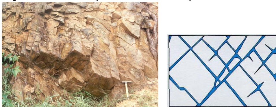
Figura 13.44 Rocha com porosidade de fratura ou porosidade secundária.
