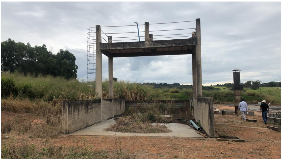
Figura 15.29 Separador de sólidos
