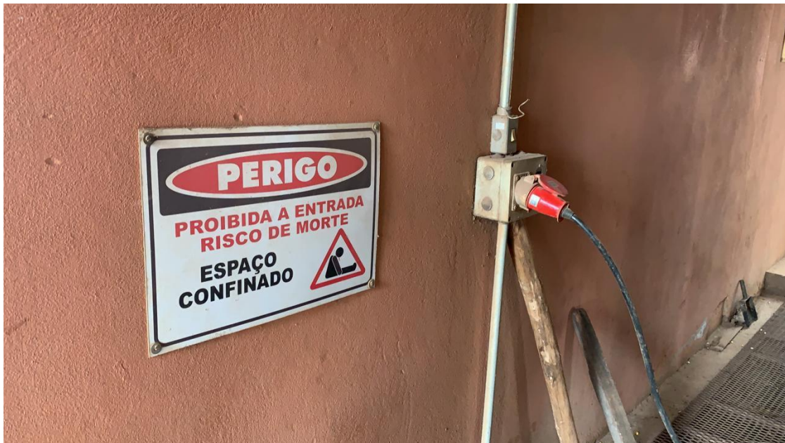
Figura 16.10 Placa de sinalização
