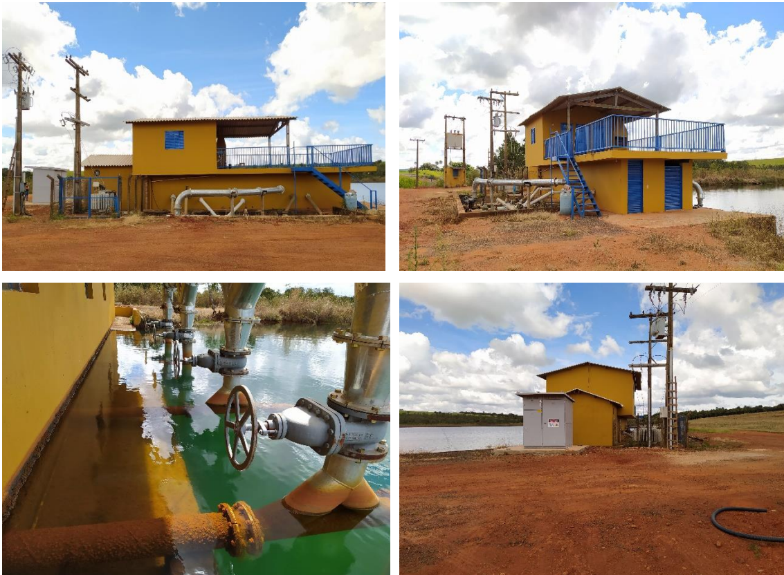
Figura 8.16 – Casa da bomba (captação direta)
