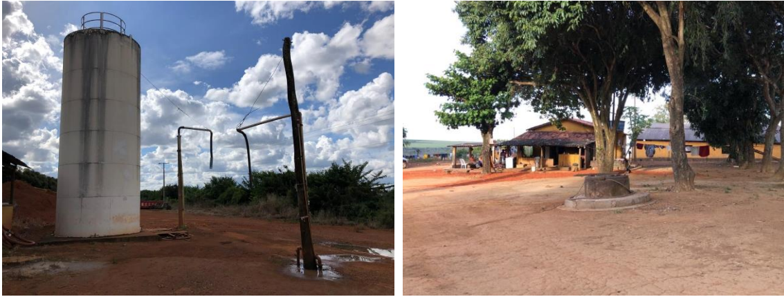
Figura 8.15 – Poço tubular com casa da bomba
