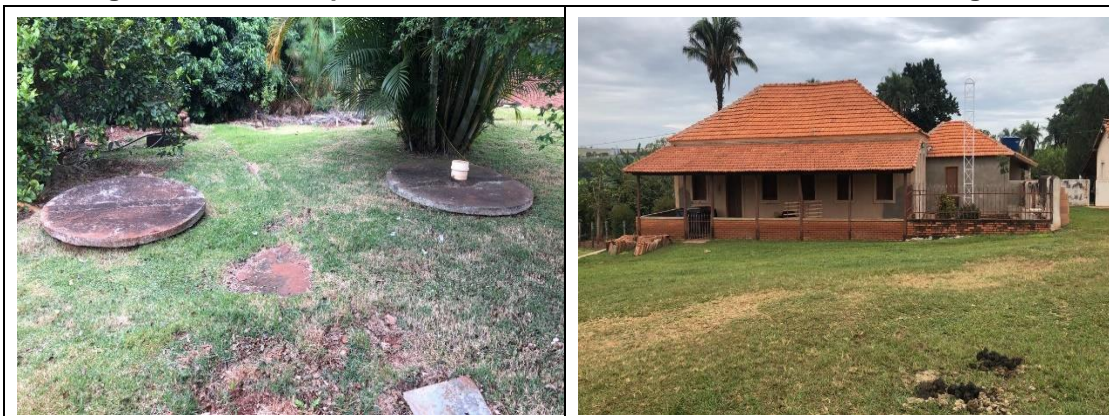
Figura 2.8 Fossa séptica – Sede da Fazenda JC Aroeira – Fazenda Varginha
