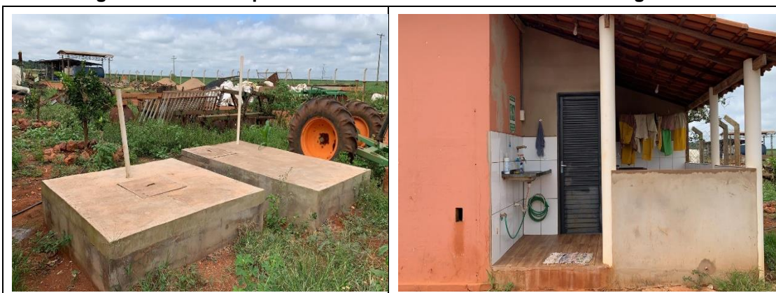
Figura 2.9 Fossa séptica – Banheiro do barracão de insumos agrícolas
