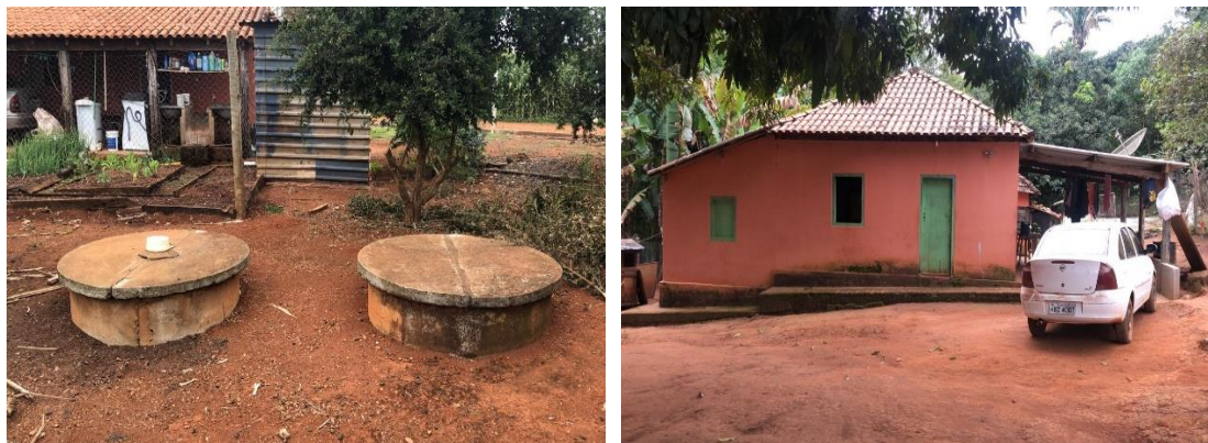
Figura 2.7 Fossa séptica - Casa dos funcionários (Fazenda Varginha)
