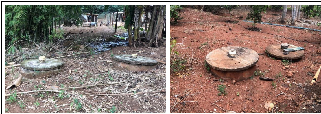
Figura 2.11 Fossas sépticas – Casa dos Funcionários - Fazenda Ypê e Sede
