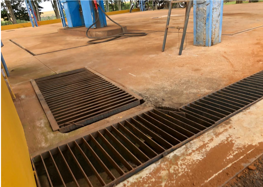
Figura 3.7 – Canaleta - Pista de abastecimento
