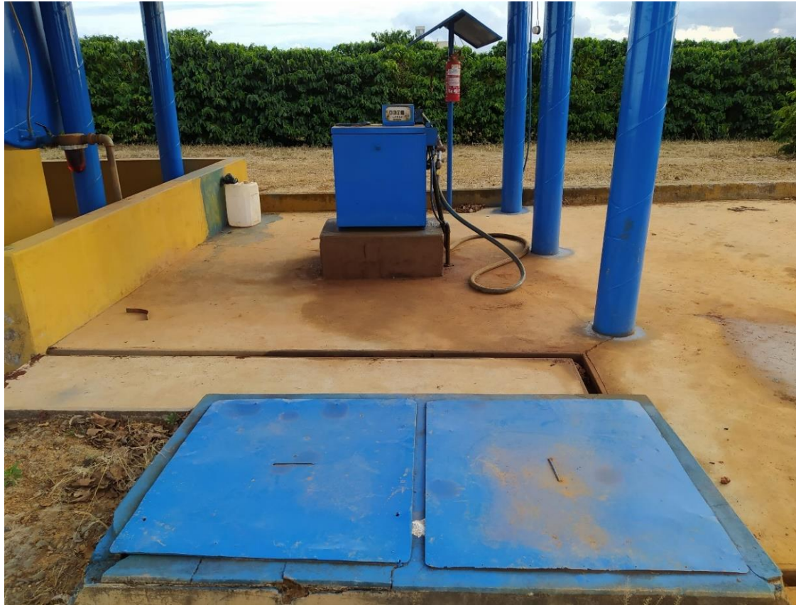
Figura 3.10 – Pista de abastecimento / Sede Café - Canaleta de contenção e Caixa Separadora de Água e Óleo
