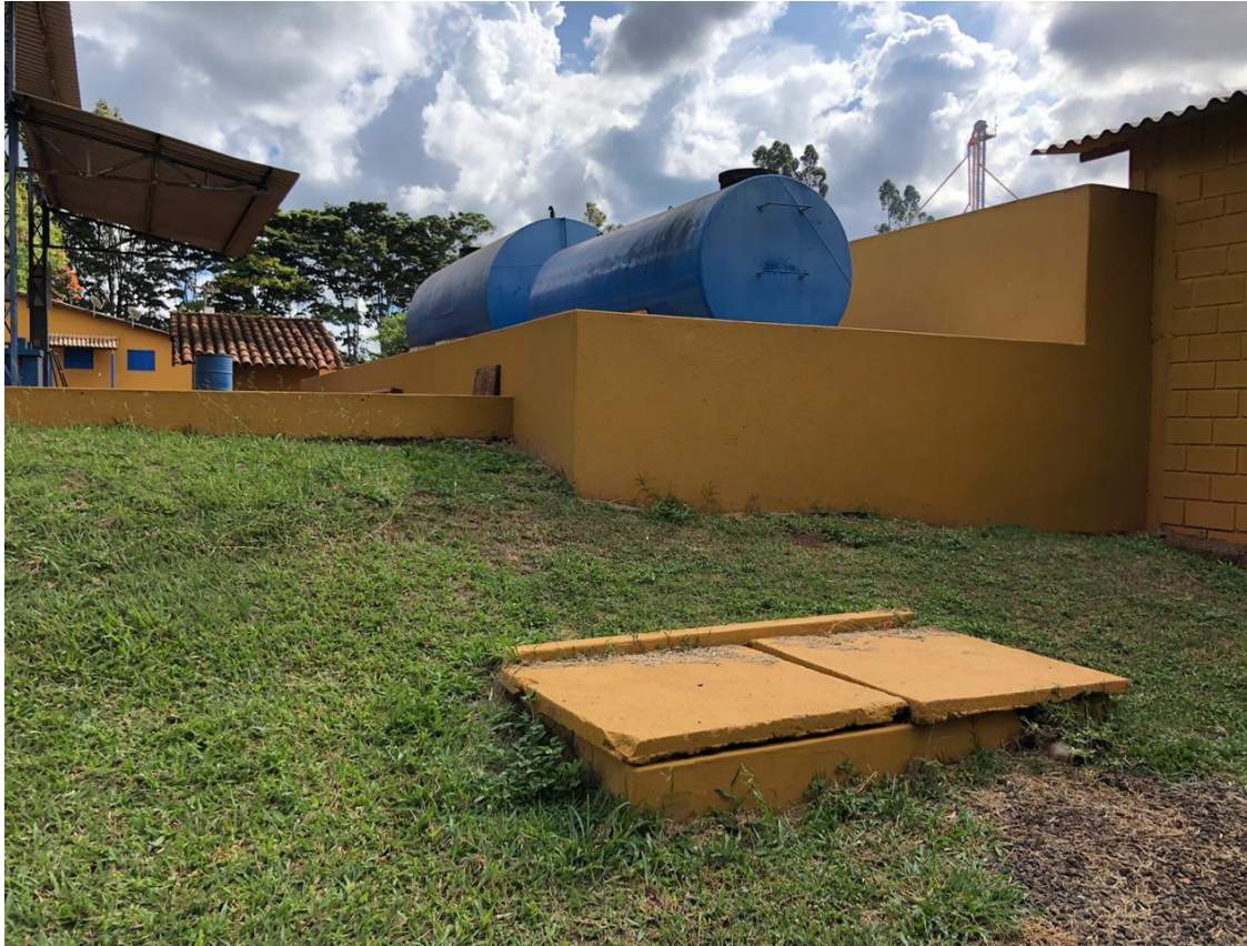
Figura 3.8 – Caixa separadora de água e óleo - Pista de abastecimento.
