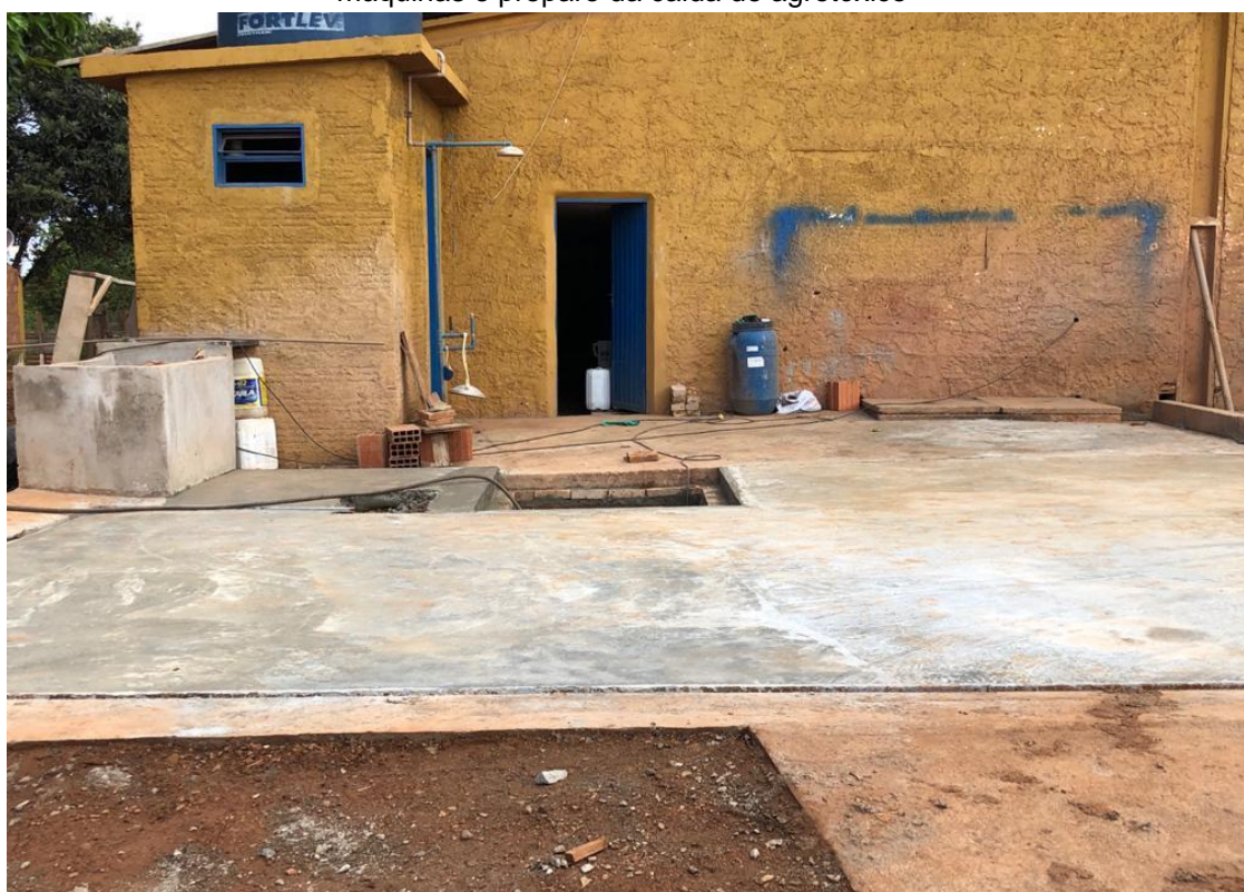
Figura 3.13 – Caixa separadora de água e óleo e canaletas de contenção / Lavador de máquinas e preparo da calda de agrotóxico
