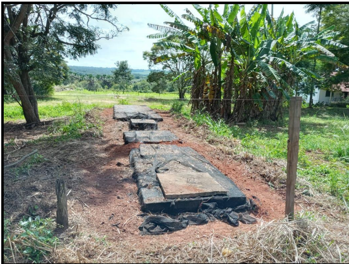
Figura 4.20. Fossa séptica 01 - Casa dos funcionários (recebe os efluentes de 3 casas)
