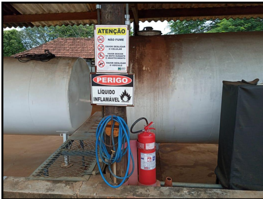
Figura 5.1. Extintor e placas de sinalização
