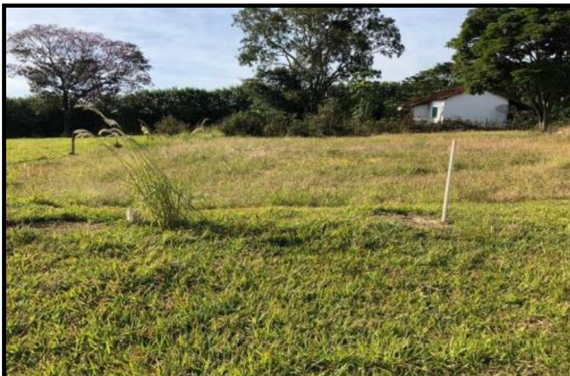
Figura 4.21. Fossa séptica 02 - Casa dos funcionários (recebe os efluentes de 2 casas)
