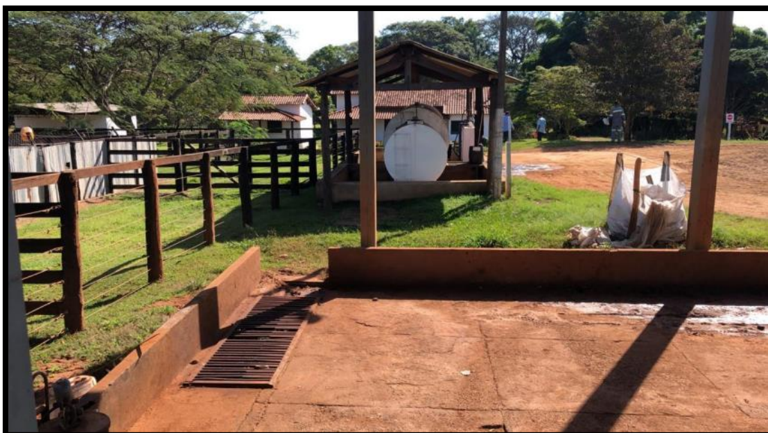
Figura 4.8. Lavador de máquinas - caixa de decantação
