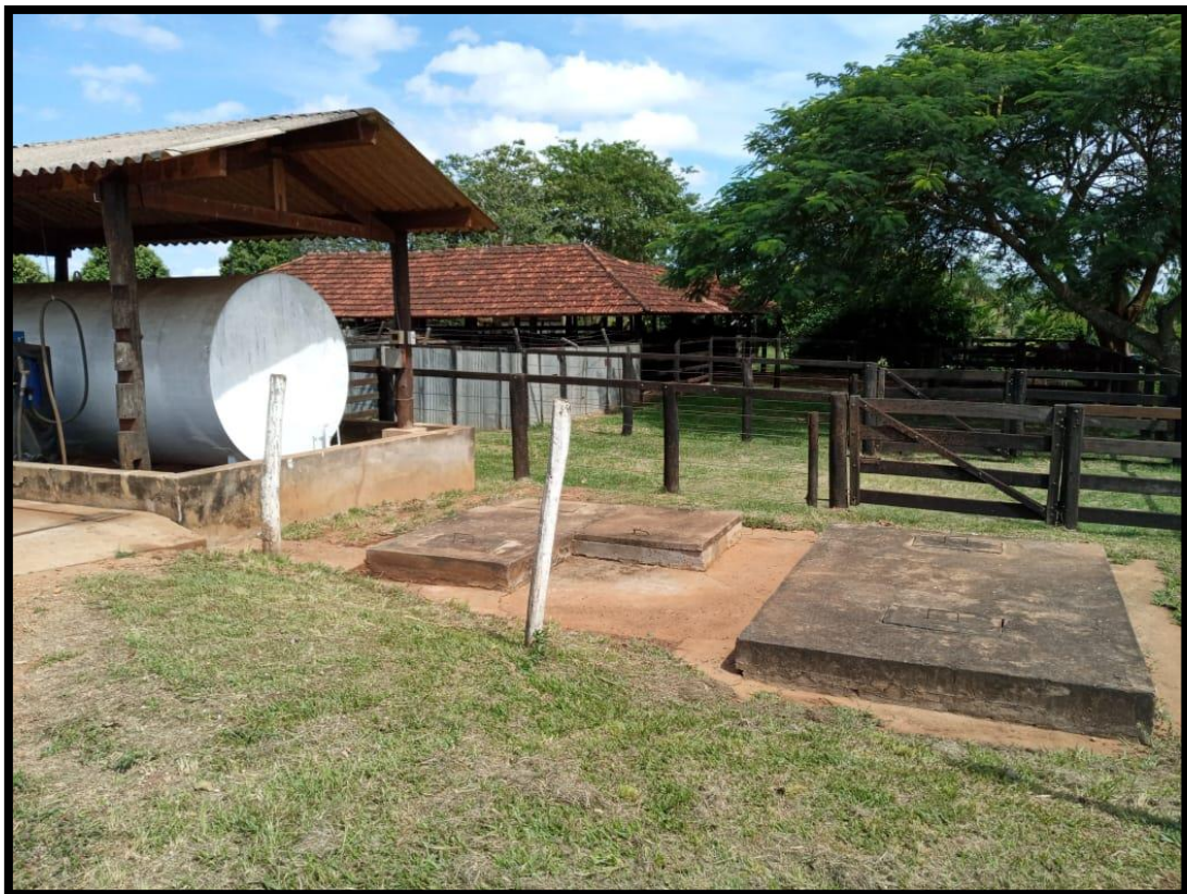
Figura 4.10. Caixa separadora de água e óleo - Pista de abastecimento.
