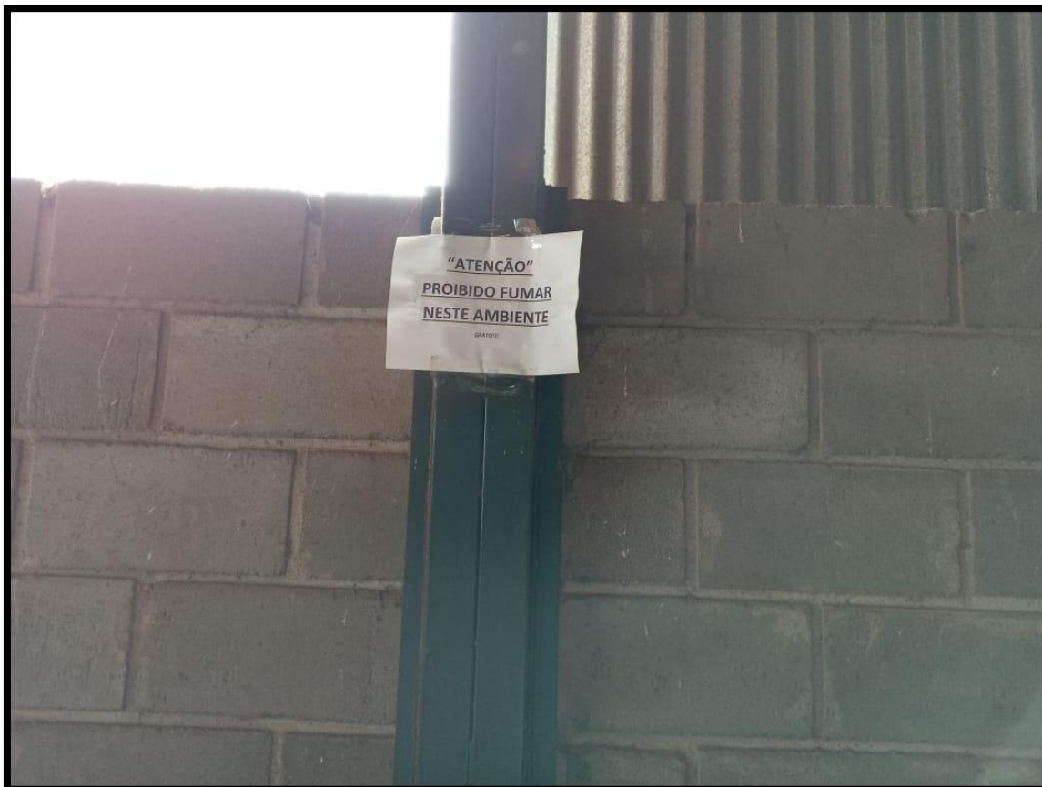
Figura 5.6. Placa de sinalização
