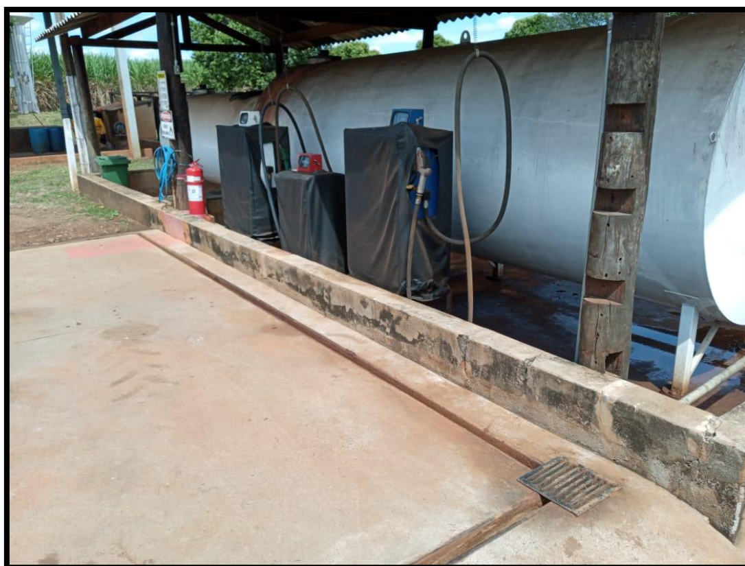
Figura 4.6. Canaleta de contenção / Pista de abastecimento
