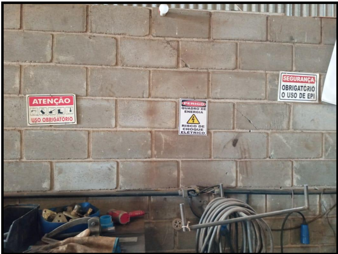
Figura 5.3. Placa indicando a obrigatoriedade do uso dos EPI's
