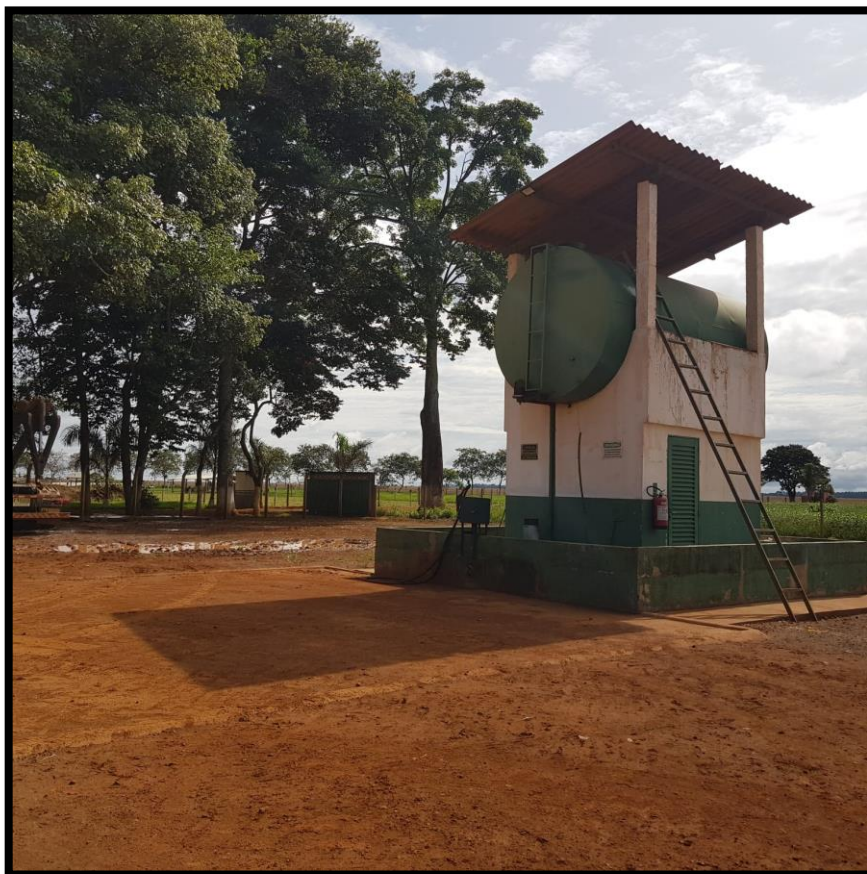
Foto 06: Tanque de combustível
