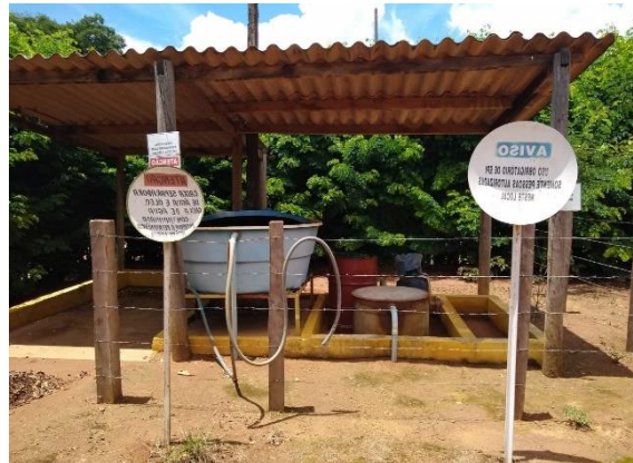
Foto 39: Caixa separadora de água e óleo – Fazenda União.
