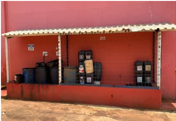
Foto 36: Deposito temporário de óleo e lubrificante – Fazenda União.
