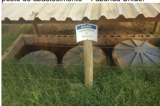
Foto 26: Caixa separadora da oficina e posto de abastecimento – Fazenda União.
