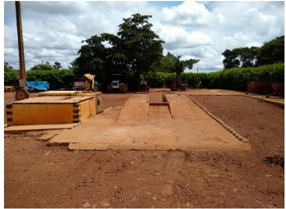
Foto 43: Lavador de máquinas com a área impermeabilizada e a saída para a caixa separadora de água e óleo – Fazenda União.
