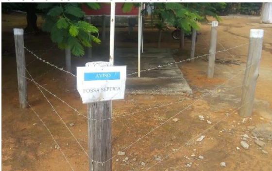
Foto 20: Fossa séptica casa dos funcionários – Fazenda Luciana.
