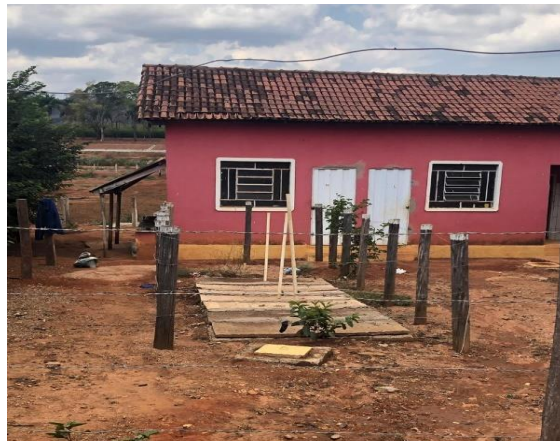
Foto 19: Fossa séptica e caixa separadora da casa dos funcionários – Fazenda Luciana.
