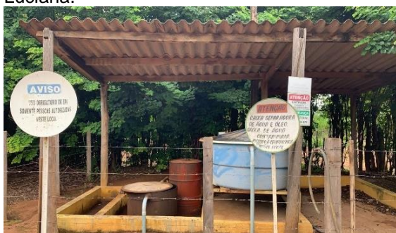
Foto 28: Caixa separadora da oficina e posto de abastecimento – Fazenda Luciana.
