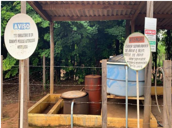
Foto 38: Caixa separadora de água e óleo – Fazenda União.
