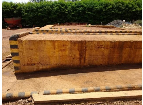
Foto 41: Lavador de máquinas com a área impermeabilizada e a saída para a caixa separadora de água e óleo – Fazenda União.
