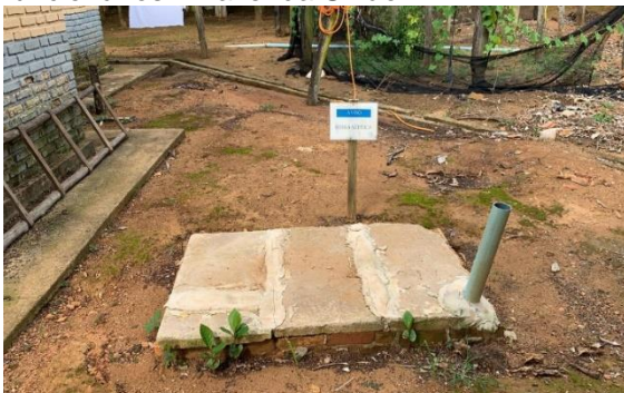
Foto 22: Fossa séptica casa dos funcionários – Fazenda União.
