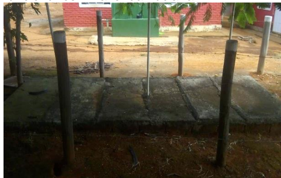
Foto 21: Fossa séptica casa dos funcionários – Fazenda Luciana.
