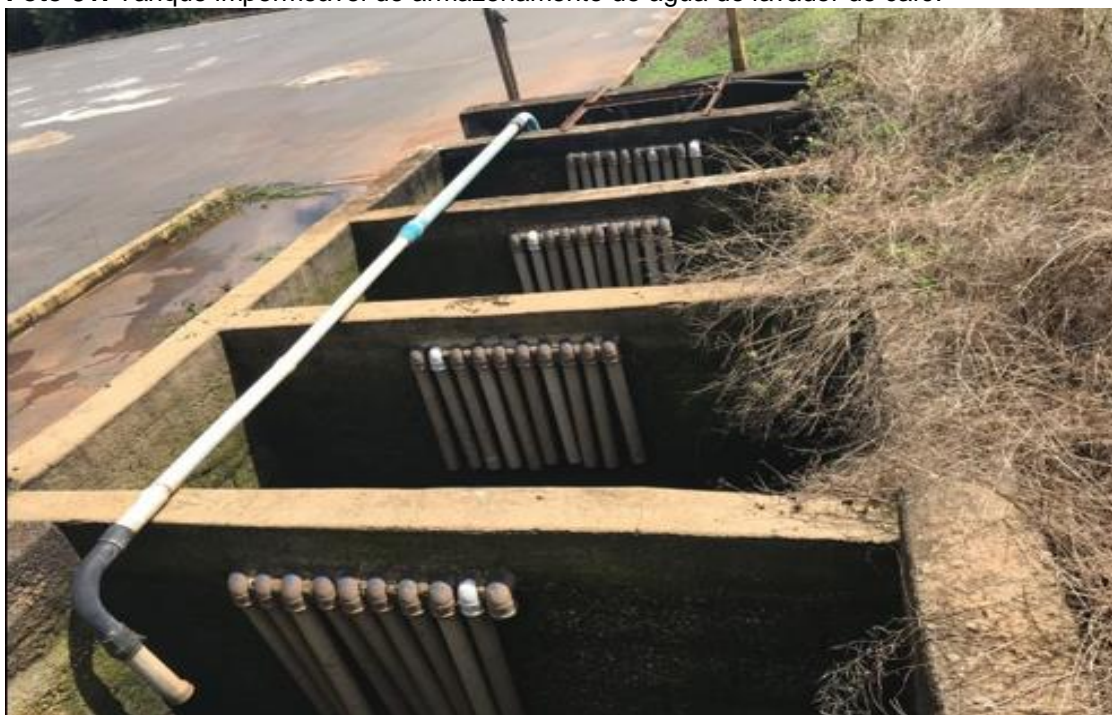
Foto 31: Tanque impermeável de armazenamento de água do lavador de café.
