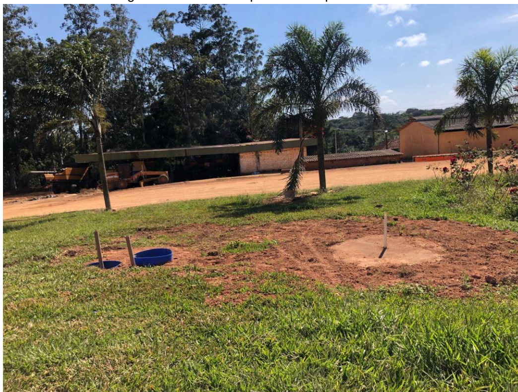
Figuras 6.1. Fossas sépticas do empreendimento.
