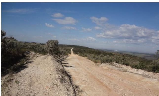
Figura 5.3.1 – Cobertura residual derivada de quartzitos do Grupo Canastra na Serra do Gavião. A base da estrada vicinal assenta-se sobre o substrato rochoso (quartzito).
