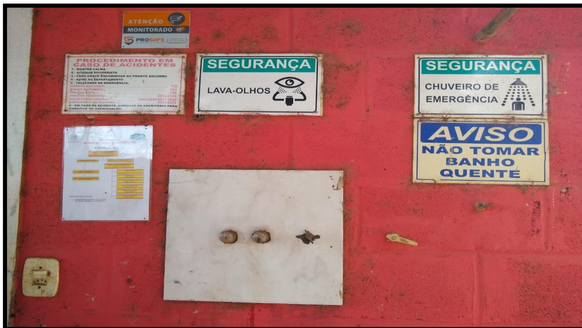
Lavador de Olhos e chuveiro de emergência
