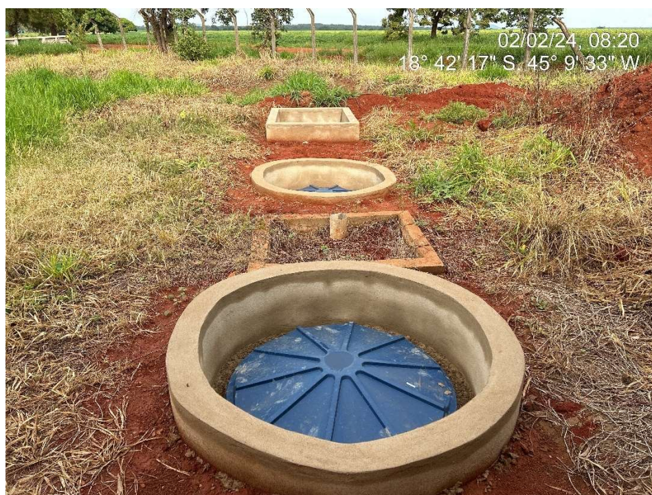
Figura 7. 5-13: Biodigestores conexos aos banheiros e lavanderia dos galpões de armazenamento de maquinários e defensivos.
