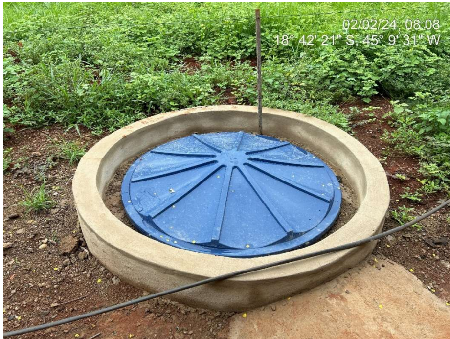
Figura 7. .5.-2: Biodigestor conexo ao alojamento de funcionários.
