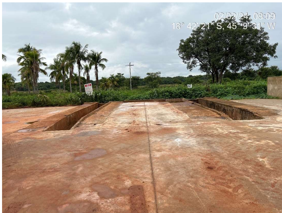
Figura 5.1-2: Lavador de maquinários.
