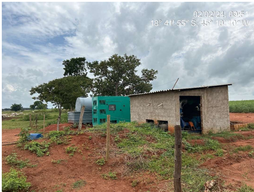
Figura 5. 1-23: Bomba para captação de recursos hídricos.
