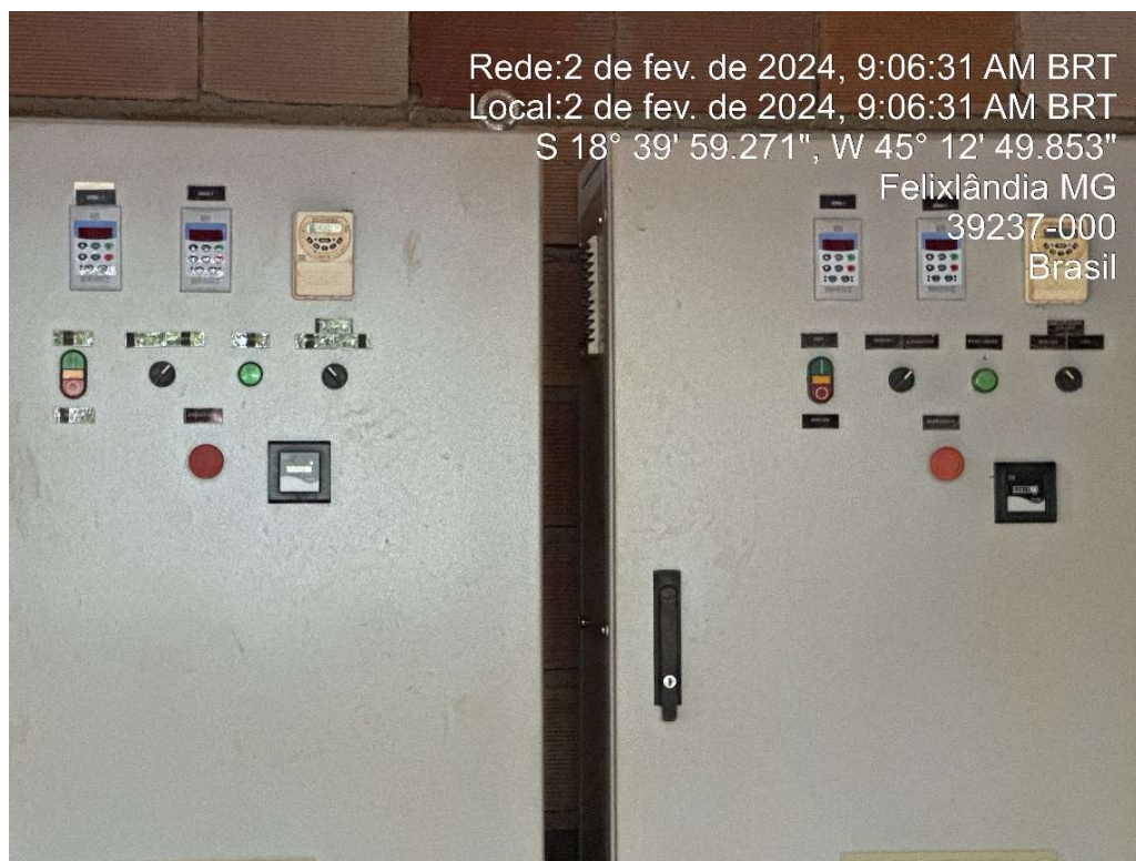
Figura 5. 1-25: Horímetros instalados em estrutura de captação de água.
