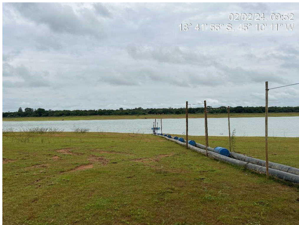
Figura 5. 1-24: Estrutura para captação de recursos hídricos.
