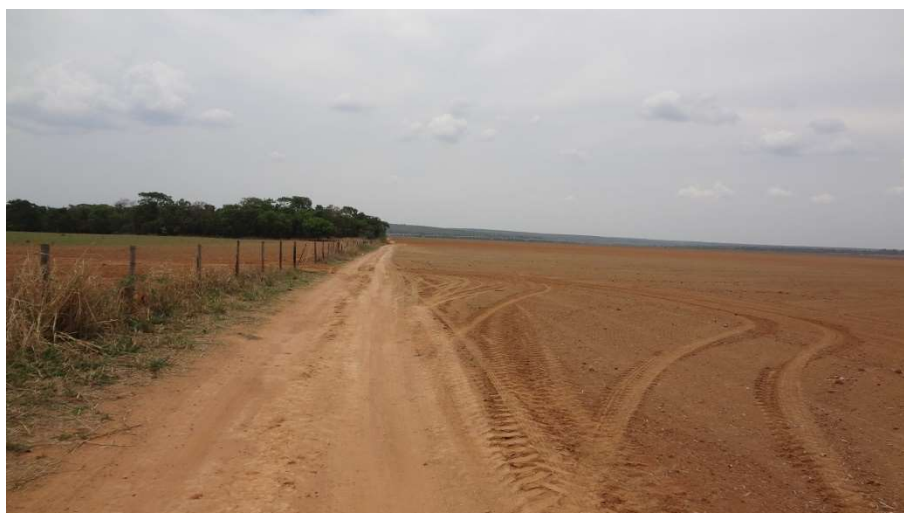
Figuras 13.7.6-5: Via de acesso secundária que corta a ADA do empreendimento sem estrutura para redução da energia do fluxo de água e coleta (bolsões).
