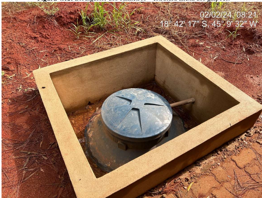
Figura 4.12: Biodigestor dos banheiros – estrutura anexa aos galpões.
