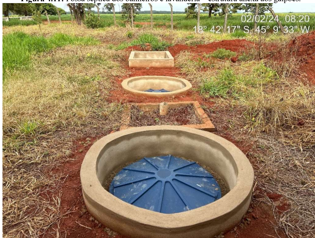
Figura 4.11: Fossa séptica dos banheiros e lavanderia – estrutura anexa aos galpões.
