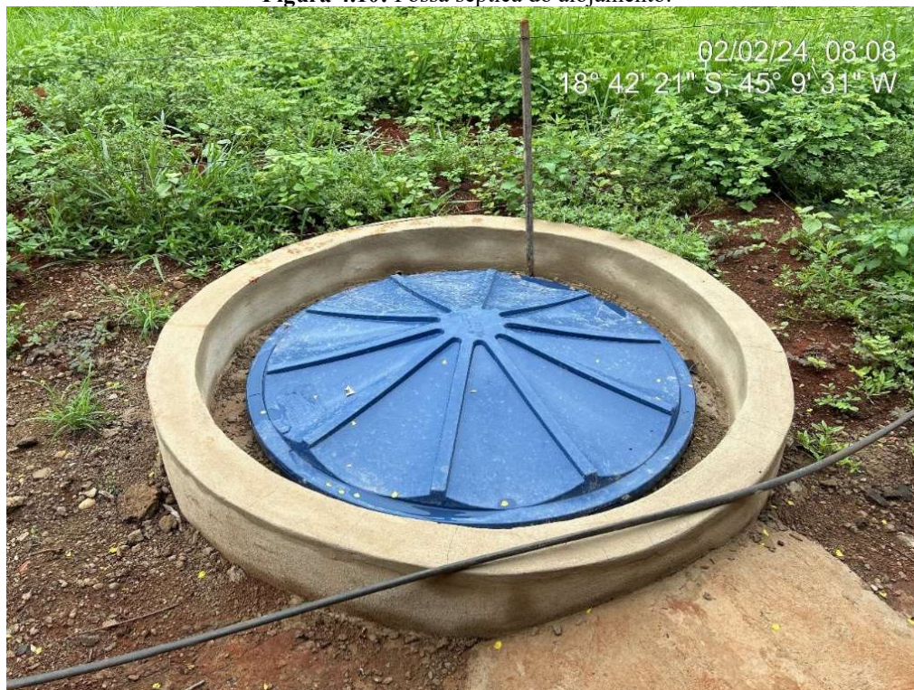
Figura 4.10: Fossa séptica do alojamento.
