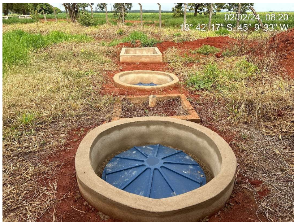
Figura 7.13: Biodigestores conexos aos banheiros e lavanderia dos galpões de armazenamento de maquinários e defensivos.
