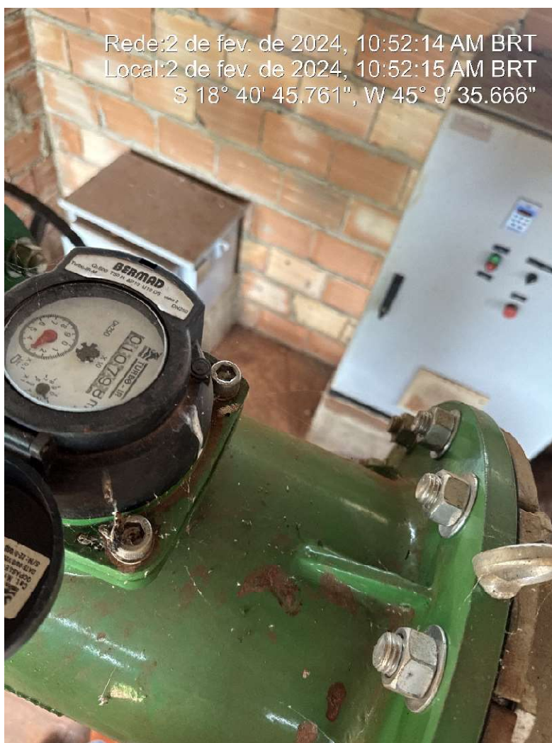
Figura 5. 1-27: Hidrômetro instalado nas bombas de captação de recursos hídricos.
