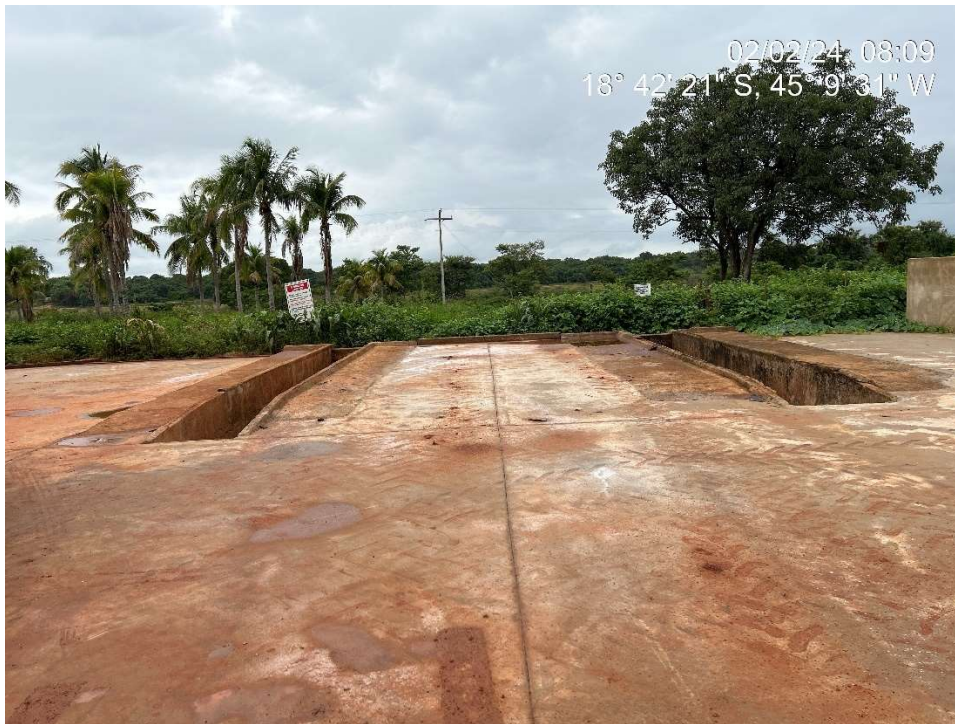
Figura 5.1-2: Lavador de maquinários.
