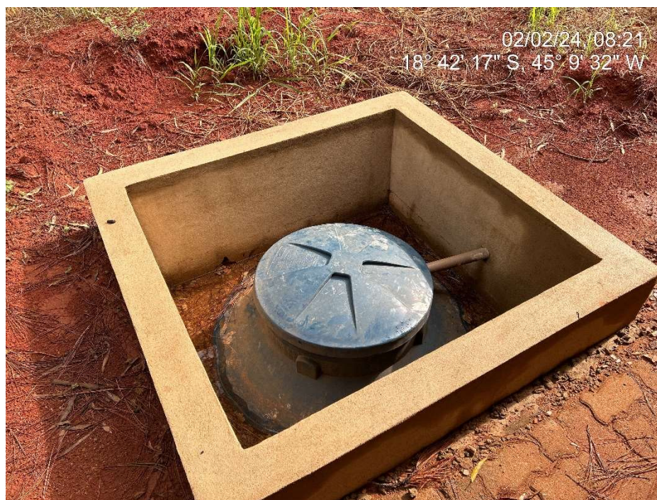
Figura 7.14: Biodigestor conexo à estruturas do galpão de defensivos agrícolas, maquinários e de embalagens vazias.
