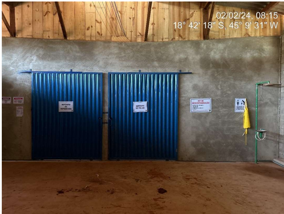
Figura 5.1-10: Depósitos devidamente sinalizados.
