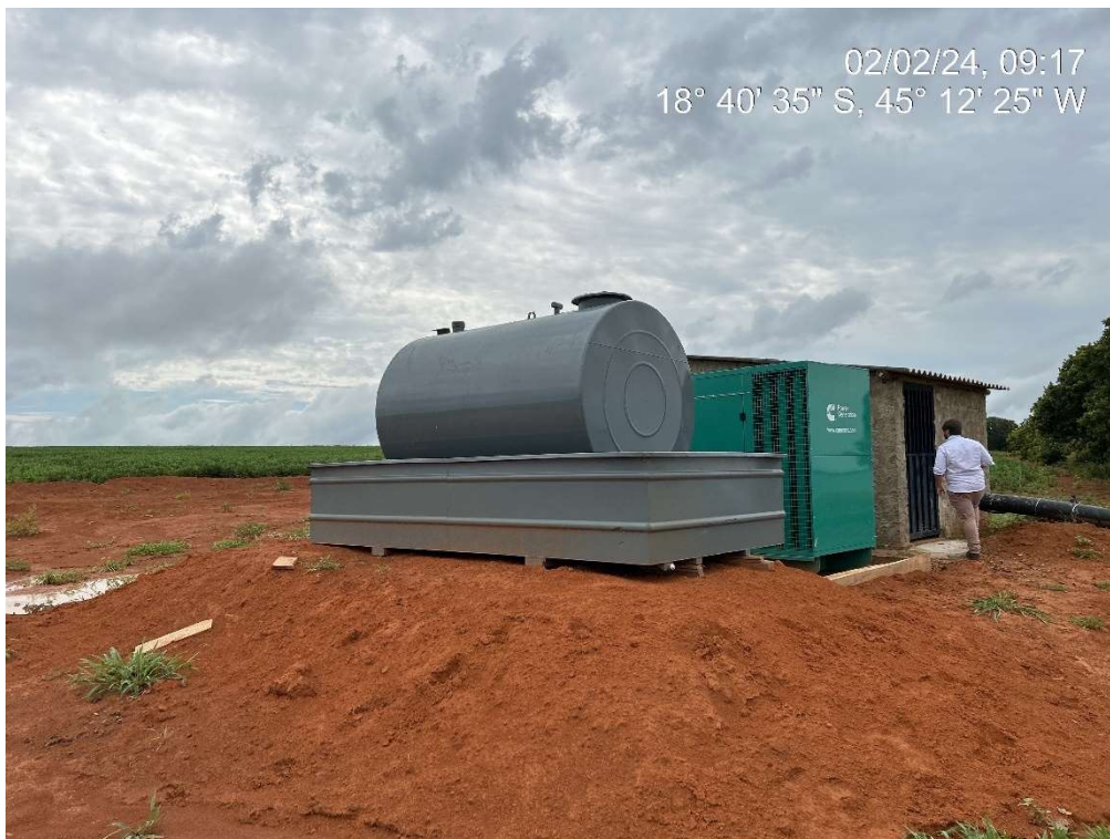
Figura 5.20: Bomba de captação de água.
